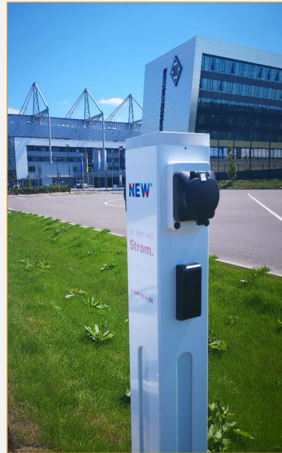
Ladesäule für E-Fahrzeuge
